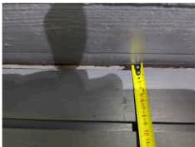
kuva 28. julkisivupaneelin ja räystäään välissä n.5 mm rako
